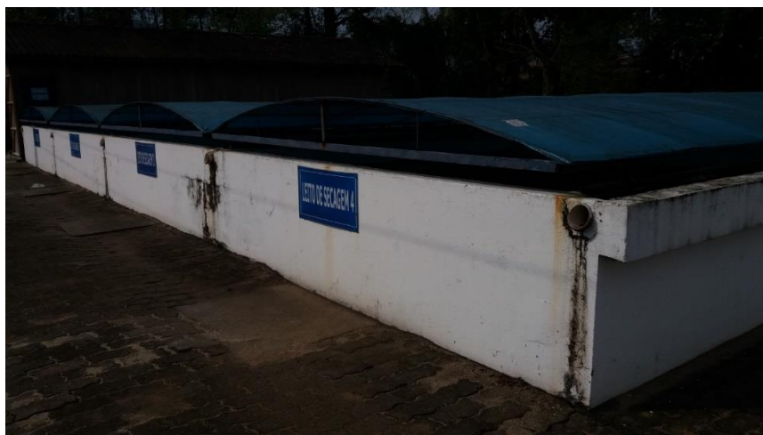
Foto 32: Tratamento do esgoto
