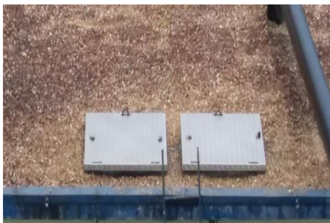
Foto 16: Caixas com suas devidas tampas
